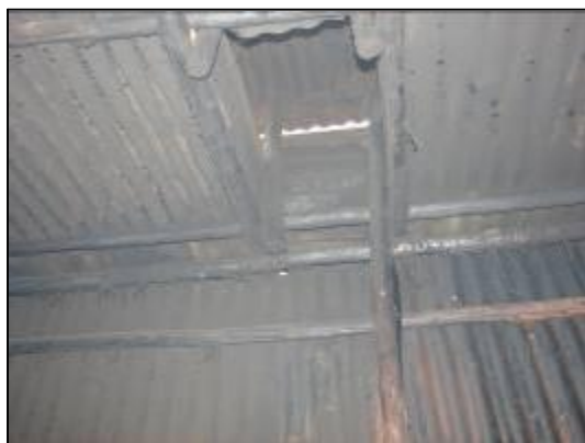
Exceso de hollín acumulado en techos y paredes
