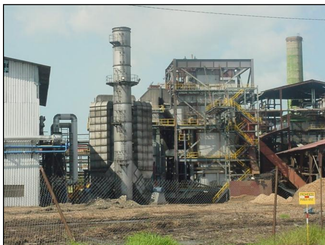
Figura 5. Planta de cogeneración en el Ingenio San Antonio, Nicaragua.
